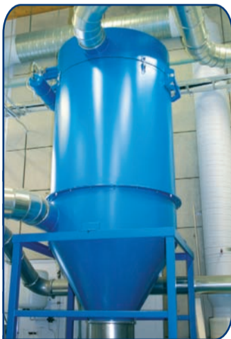
Huoltomiesten arkipäivää ovat suodattimien vaihdot patruunasuodattimiin.
